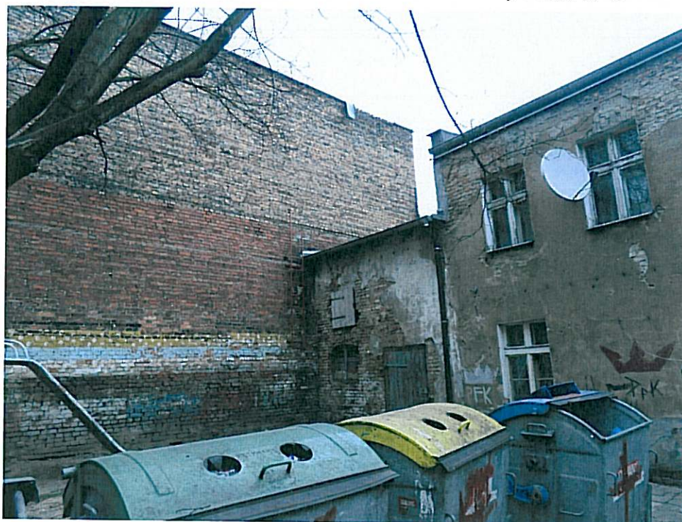
Elewacja tylna – styk budynku g1 na działce nr 14 – widok od strony działki nr 14
