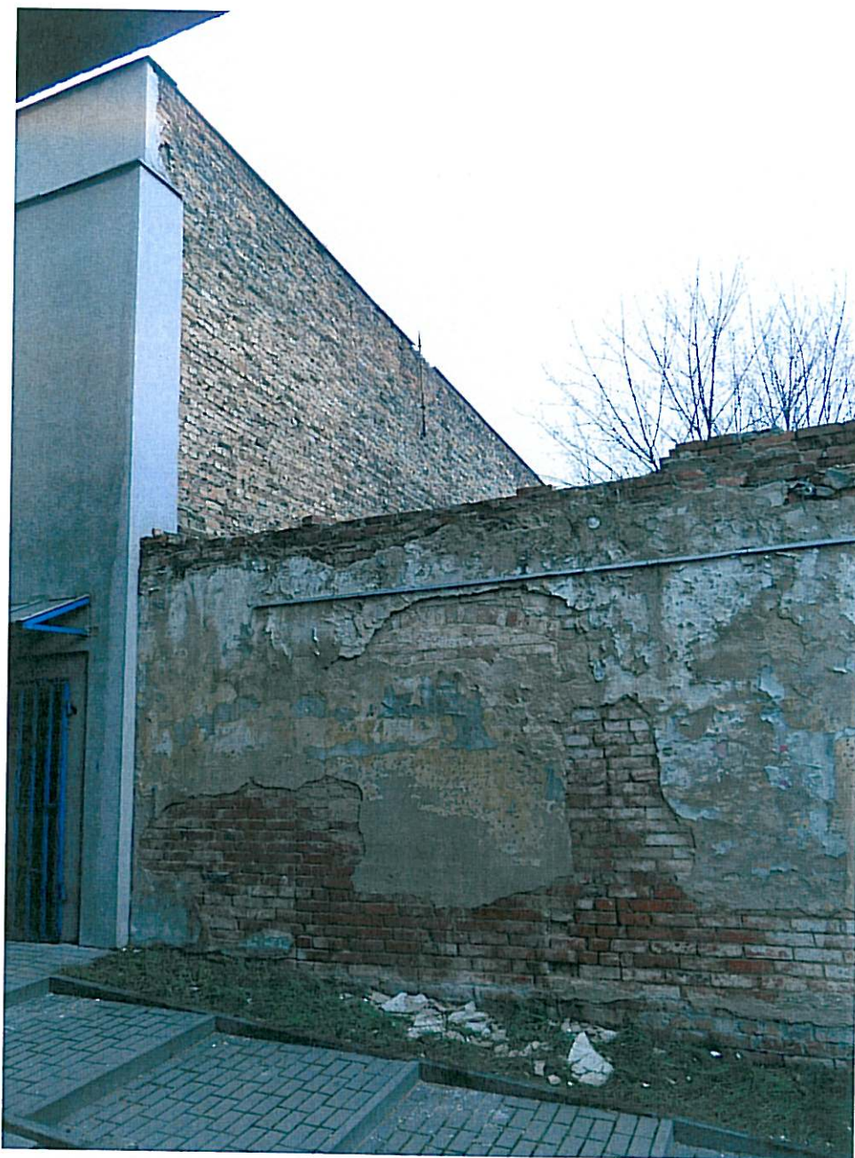
Styk budynku z murem granicznym działki nr 14 – widok od strony działki 12/3
